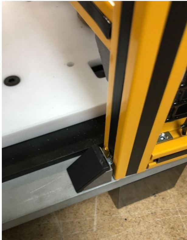
Figura 9. 2. Proyecto Servo Prensas mala instalación. Fuente: KASAI.
